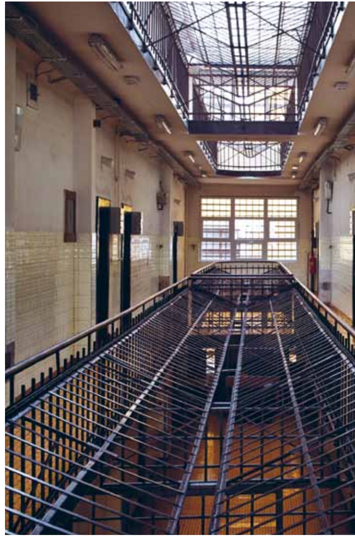
In manchen europäischen Ländern sind Gefängnisse und Heime in einem desolaten Zustand.
